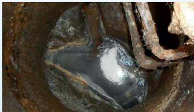
Stagnation des eaux usées
